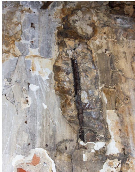
1) Een van de ankers van de verdiepingbalklaag gezien vanuit Boekhorststraat 51. (foto P. Bosman)
