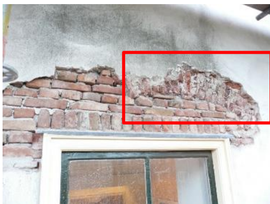
afbeelding 105 Foto N2 rollaag2009. Het kozijn is gedateerd 1924. Boven de rollaag is een aanzet van een ontlastingsboog zichtbaar 2009. (ME2) 17112009 f17
