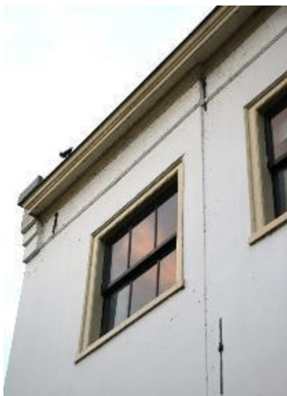
afbeelding 119 Foto van de sprong in pleisterwerk Z1 2022.
