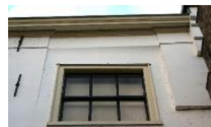
afbeelding 127 Foto van sprong in pleisterwerk in tiende travee Z3 2022.
