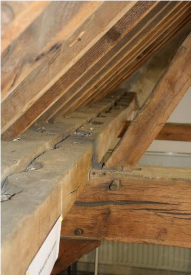
afbeelding 162 Foto spant1 zuid 2022. De fliering is voorzien van inkepingen tbv de oplegging van de oorspronkelijke sporen. De linker fliering is geplaatst bij restauratie van de kap. Uiterst links de nieuwe sporen geplaatst in 2009.
