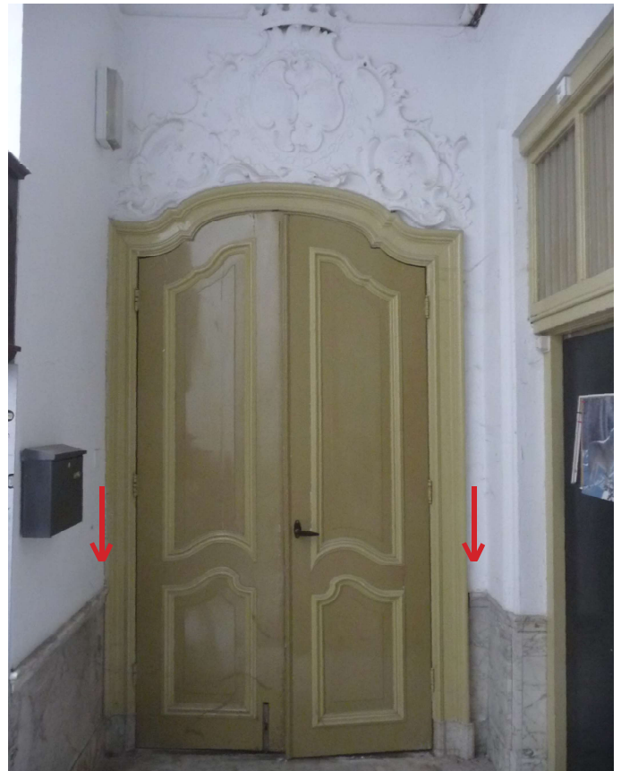
Afb. 11 Middenportaal in de gang op de begane grond, gezien richting voorgevel, met erboven een alliantiewapen in stucwerk, 2022. Dat het portaal niet exact in het midden is geplaatst is te zien aan de lambrisering rechts van de deur en het ontbreken daarvan aan de linkerzijde (zie rode pijlen)
