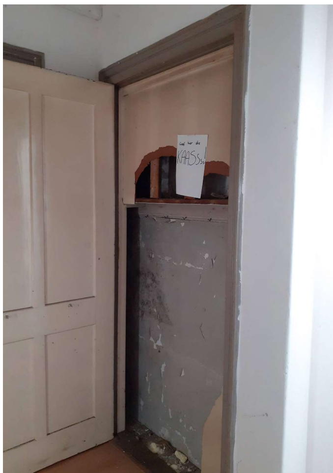
Afb. 29 Voormalige toiletdeur die op een blinde muur uitkomt in de middengang op de 2e verdieping, 2022
