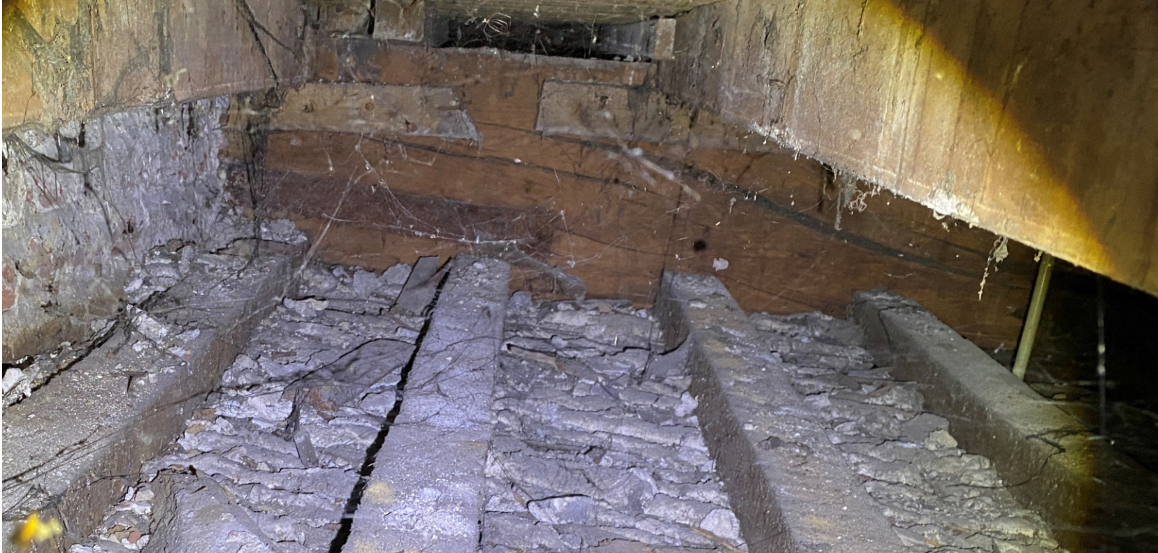
Vloerbalk onder gebintstel 1 in zuidelijke hoek. De onderliggende ruimte is voorzien van een historisch stucplafond waarvan de draagconstructie zichtbaar is (en het stucwerk om de rietlatten heen is gekruld). De strop is met smeedijzeren nagels aan de vloerbalk bevestigd, de vloerbalk zelf is voorzien van enkele klampen om de draagbalken van de vernieuwde vloer te kunnen dragen.
