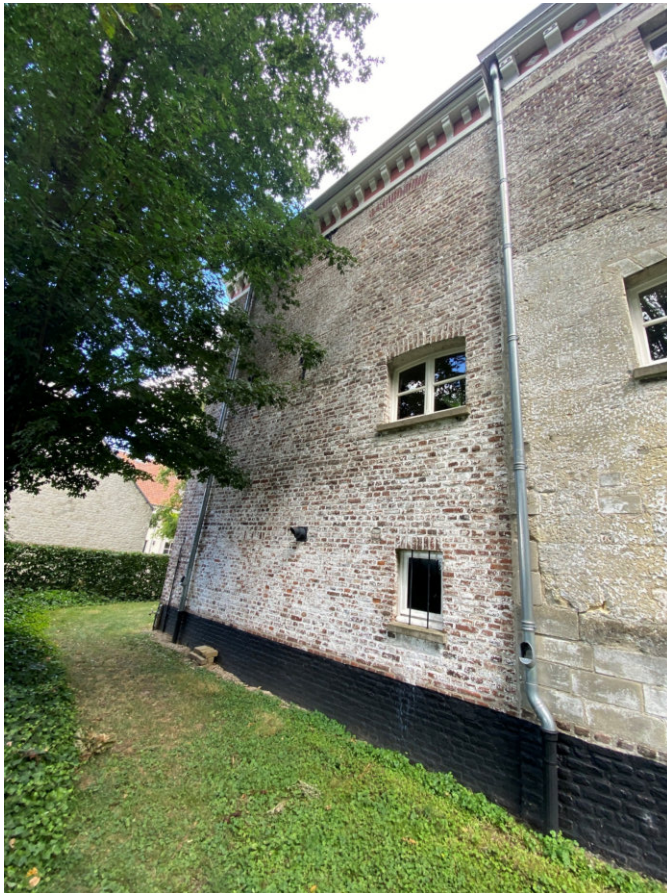
De westelijke wand van bouwdeel C. Op de tweede verdieping en de begane grond zijn restanten zichtbaar van een dichtgezet venster, de vensters op de begane grond en eerste verdieping zijn secundair ingebracht. De plint is ingeboet.
