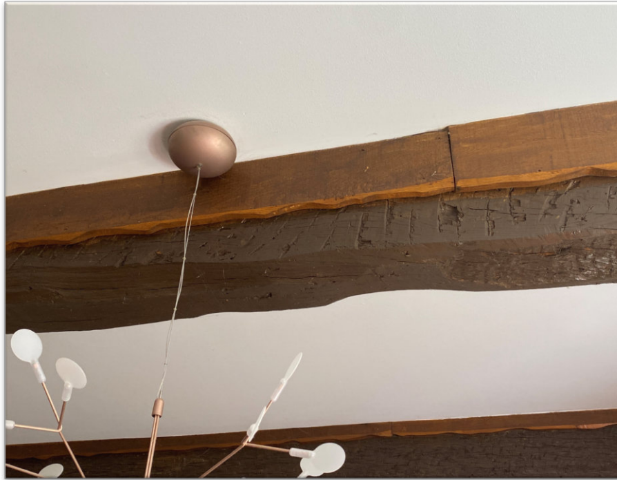
Ruimte B.1.6 met grof behakte houten balken aan het plafond duiden op omstucen ervan in de 18 de eeuwse traditie.
