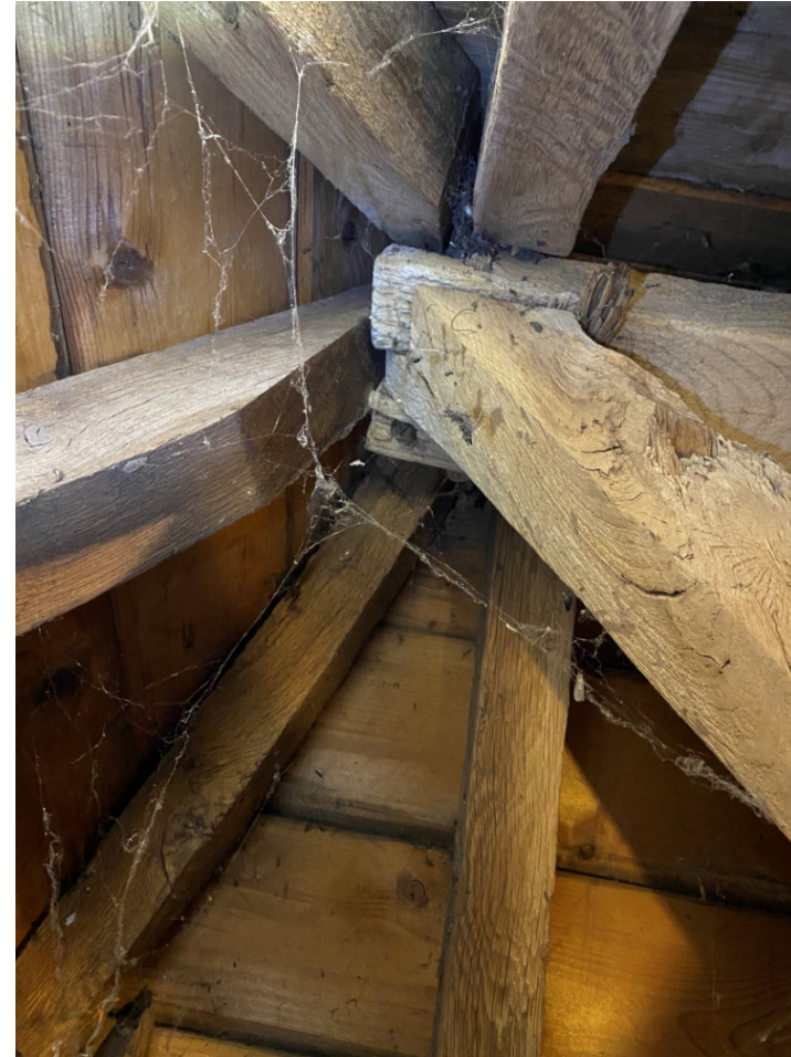
Niet-effectieve verbinding (schoor is drukbelast normaalgezien) aan oostzijde van gebintstel 1 wat aanpassing van oorspronkelijke constructie suggereert.
