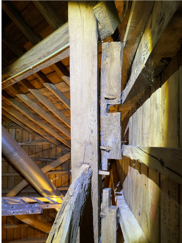
Uitvulling tussen gording en sporen in travee I noordelijke zijde, noodzakelijk na extreme vervorming van deze gording. :
