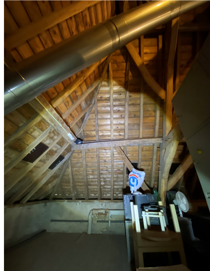
Travee I in zuidelijke richting waarop duidelijk vervormde gording na schoor zichtbaar is.
