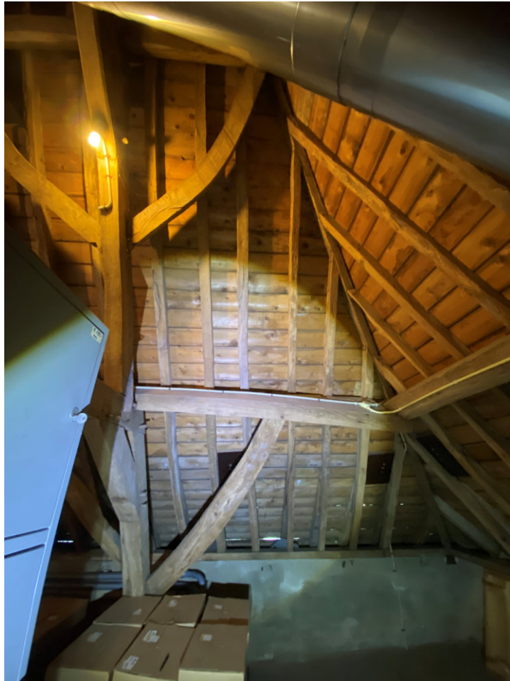
Travee I in noordelijke richting. Duidelijk vervormde gording na schoor.
