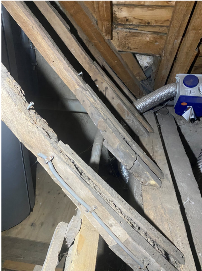
Zichtbare aanlopers op de overgang tussen de kappen van bouwdelen C en D. De aanlopers zijn voorzien van nagelgaten op regelmatige afstand ten behoeve van leilatten. Het gebruik van leilatten geeft aan dat hierop leien in Maasdekking zijn aangebracht geweest in het verleden.
