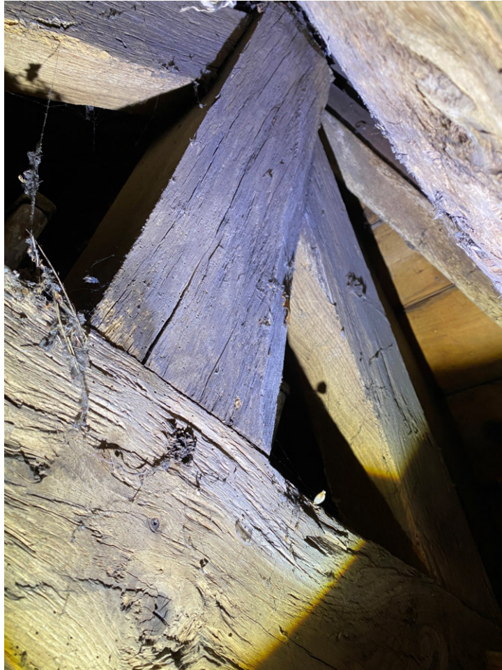
Geen spoor van schoor in koningsstijl gebintstel 7 aan westelijke zijde zichtbaar wat afschuining kap als oorspronkelijk suggereert.
