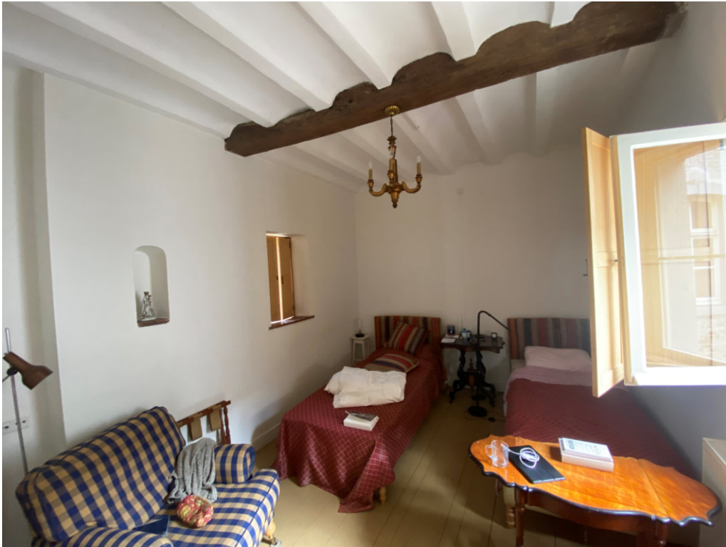
Ruimte D.1.1 is huidig in gebruik als slaapkamer en is voorzien van een troggewelf met vlakliggende houten balken ondersteund door moerbalken. In de noordelijke wand is een kaarsnis aanwezig. De kaarsnis kunnen bestempelen als voormalig doorvoergat voor de hijskabels van de ophaalbrug is niet mogelijk geweest door het ontbreken van een gedetailleerde opmeting en gelegenheid tot licht destructief onderzoek naar de dichtzetting. De wand is wel ter plaatse van de onderdoorgang (ter verstijving) aanmerkelijk zwaarder uitgevoerd dan de naastgelegen wand.
