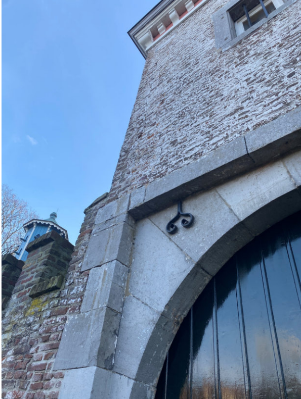
Bovenhoek van de geblokte omlijsting van de poort waarin door middel van kleine blokjes de inkeping voor de sprieten van de ophaalbrug zichtbaar zijn. De dichtgezette sleuf voor de sprieten en de Naamse-stenen afdekker van deze sleuf zijn nog aanwezig. De omlijsting van de poort en de zware hardstenen raamkaders zijn stilistisch vergelijkbaar met exemplaren uit de Maaslandse Renaissance-stijl XVIIa.
