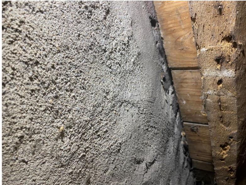
Vanuit bouwdeel C (lagere dak) is het beginpunt van het boerenvechtwerk in de doorgestoken topgevel te zien. De legmortel oogt echter niet (waar zichtbaar) uit de bouwtijd waardoor niet met zekerheid vast te stellen is dat het bovenste gedeelte van deze wand niet opnieuw is opgemetseld ten tijde van de restauratie.
