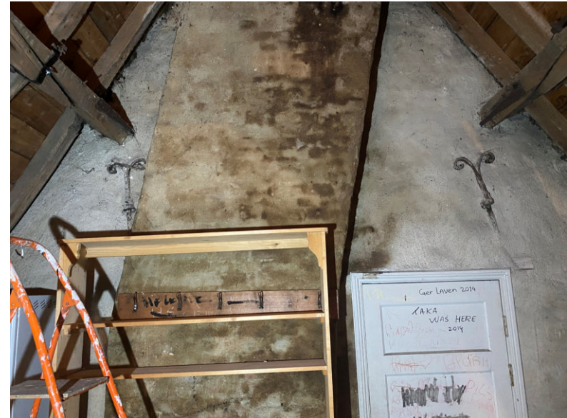
Aanzicht vanuit bouwdeel A richting C. Duidelijk is te zien dat de kap van bouwdeel C lager ingrijpt, de gevelankers zijn lager geplaatst. De korte stukken gording van de kap van bouwdeel A zijn niet verankerd aan de veren van de gevelankers (niet vernageld) waarmee aanpassingen in het muurwerk voor de hand liggen. Het rookkanaal is overtuigend wel van oudere datum.
