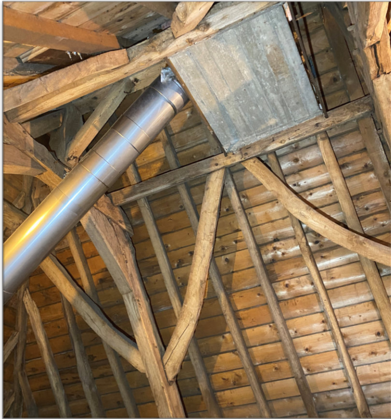
Ondersteuningsconstructie voor dakdoorvoeren die tijdens de restauratie zijn gerealiseerd. De oorspronkelijke rookgasafvoeren van de schouwen op de eerste verdieping zijn (uitgezonderd het kanaal tussen B.1.4 en B.1.6) niet meer aanwezig. De historische locatie van kanalen kan in eerste indruk niet meer uit de kapconstructie worden afgeleid.
