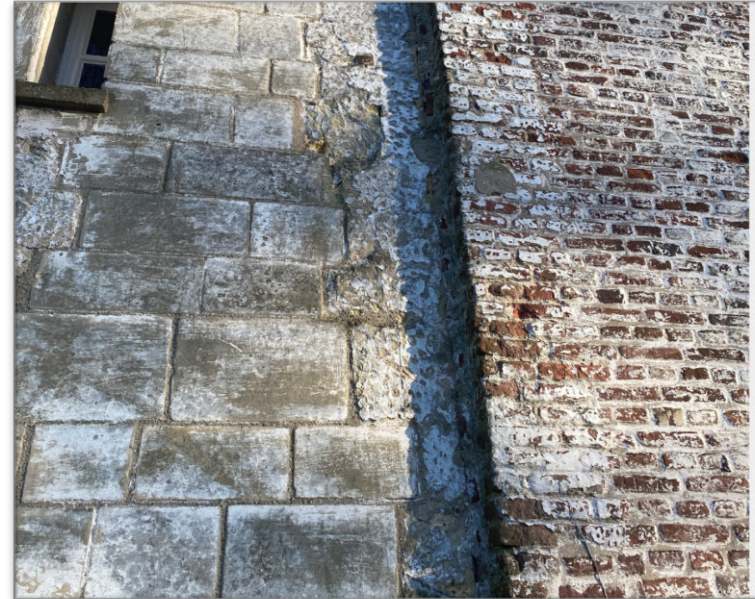
Aanzicht van de westgevel van Ten Hove waarin de mergelkern zichtbaar is. De oorspronkelijke mergelkern is met een bijl behakt ten behoeve van stucwerk. Latere ingebrachte vensters zijn niet behakt. De plint is later in metselwerk ingewerkt. De muurankers zijn van verschillende bouwfasen (II en III).
