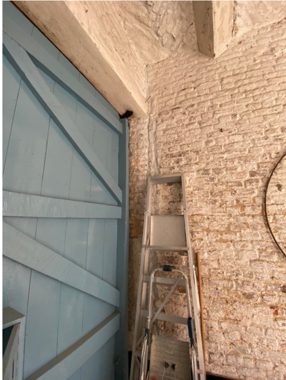
Zicht in de hoeken van D.0.1 waar een dichtgezette sleuf zichtbaar is die doorloopt tot bovenzijde van de houten latei. Onduidelijk is waar deze ruimte oorspronkelijk voor gediend heeft.
