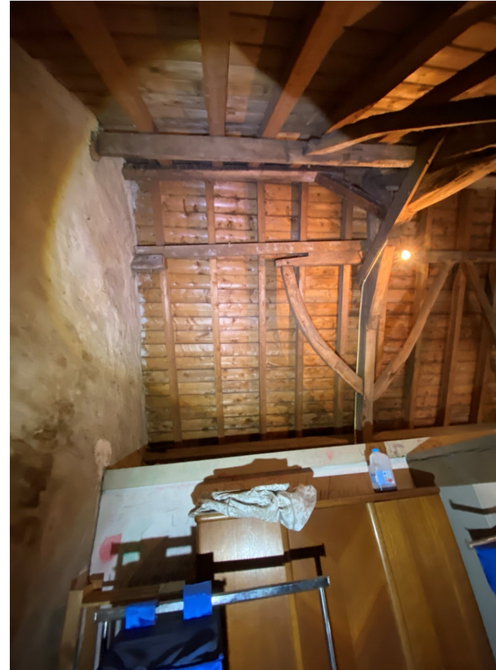
Travee VI in noordelijke richting. Hier is zichtbaar dat de onderste gording en schoren niet zichtbaar zijn en dat de tweede aanpassingen heeft doorgemaakt. Vernieuwde sporen.
