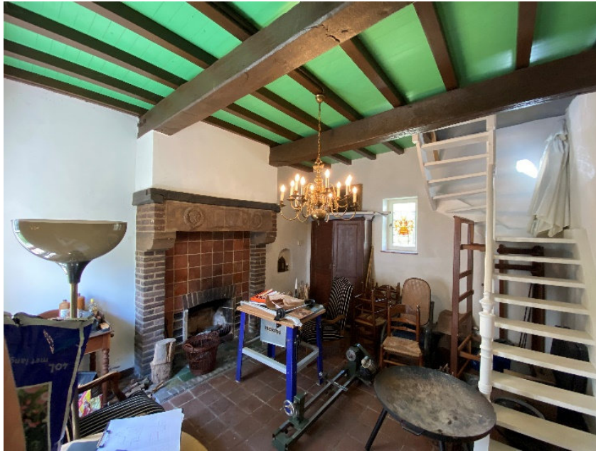
Zicht in ruimte E.0.1 waarin een schouw met wapenstein is geplaatst, een kaarsnis met getoogd plafond. De vloerconstructie van de etage is recent van datum (zowel moer- als kinderbinten) en de tussenliggende vloer. De trap is hedendaags in uitvoering alsmede de vloerafwerking van plavuizen in cement.
