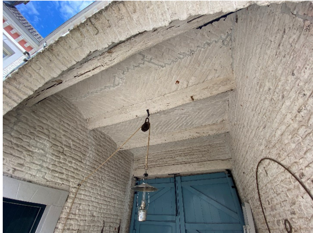
Onderdoorgang D.0.1 is voorzien van een troggewelf in oost-westelijke richting gedragen door 45 graden gekantelde balken. De gewelven zijn in visgraat-motief vermetsteld en gewit samen met de draagbalken.
