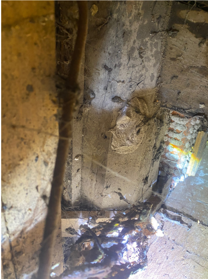
Westelijke aansluiting krommer en onderliggende vloerbalk van gebintstel 8 welke gespijkerd is in de vloerbalk (in plaats van gepend) wat de latere aanpassing nogmaals bevestigt (afbeelding is 90 graden naar rechts gedraaid)
