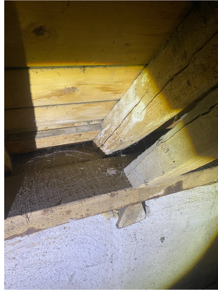
Aanlopers en muurplaten zijn vernieuwd ten tijde van beschieting kap in bouwfase VII (1953-1955, conform restauratiebestek).
