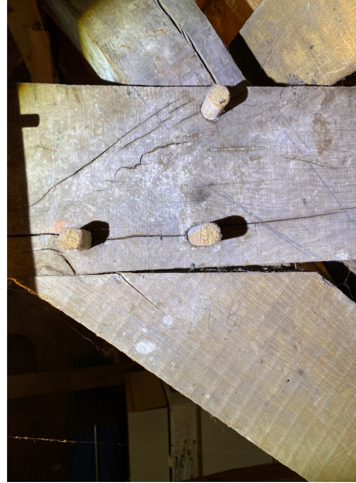
Essen ronde toognagels in machinaal gezaagd spantbeen, dekbalk en schoor in gebintstel 3
