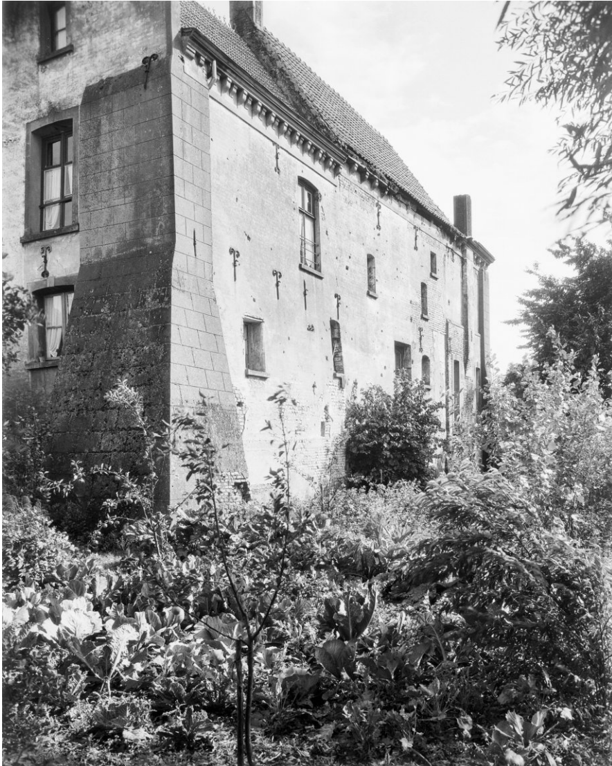
Zicht op noordwestelijke hoek (bouwdelen A, B en C. Te zien is (naast aanzienlijke schade aan het consolefries) de opvallende in blokmotief gestucte steunberen (waaronder fundamenten en een waterput zijn aangetroffen ten tijde van de restauratie. Ook opvallend is de schoorsteen ten behoeve van de sleutelhaard in B.0.3.
