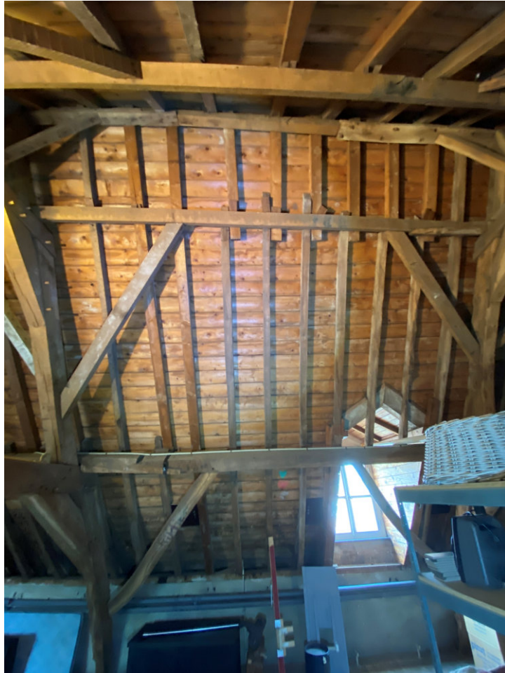
Travee III in noordelijke richting. Nokgording vernieuwd ten gevolge van verwijderen muur en rookgaskanaal in 1953-1955.
