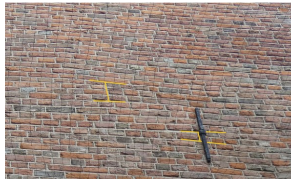
Afbeelding 3.86 Twee varkens in de noordelijke zijgevel, aangegeven in geel. Ook het onregelmatige metselverband is hier zichtbaar.
