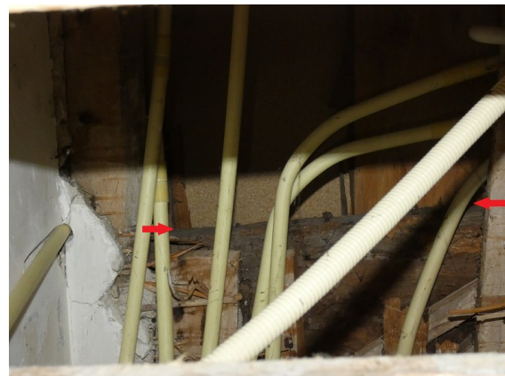
Afbeelding 3.54 Fragment van de balk boven in de meterkast. De voorzijde van de balk is met pijltjes aangegeven.
