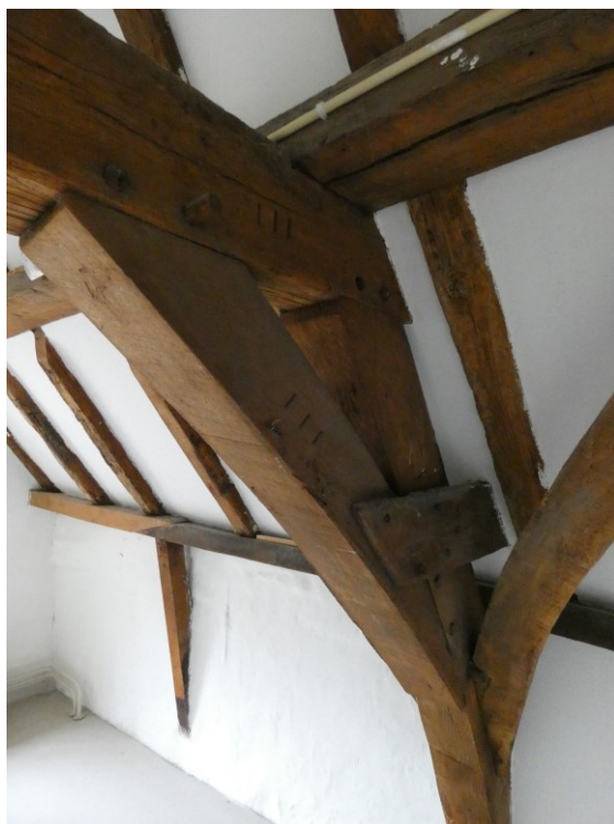
Afbeelding 3.27 Een spantbeen. Op het korbeel en op de jukdebalk is als telmerk 'III' gehakt.
