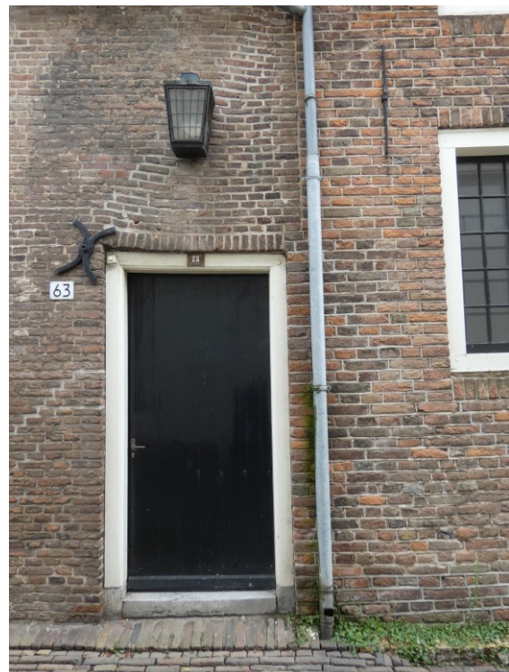
Afbeelding 3.105 De ingang van het achterhuis, met het verzakte muurwerk boven de deur en de overgang tussen het muurwerk van het achterhuis en het pakhuis.
