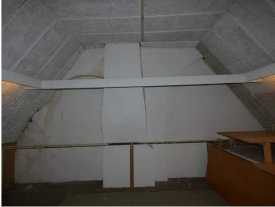
Afbeelding 3.108 De bovenverdieping naar het noorden gezien, met aan weerszijden van de schoorsteen een grote spaarboognis. De grotere nis rechts loopt buiten verder.
