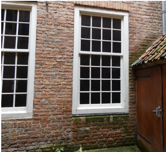
Afbeelding 3.64 De schuifvensters op de begane grond. Toognagels ontbreken in de onderdorpel van het rechter venster. De mosgroei eronder duidt op een vochtprobleem.
