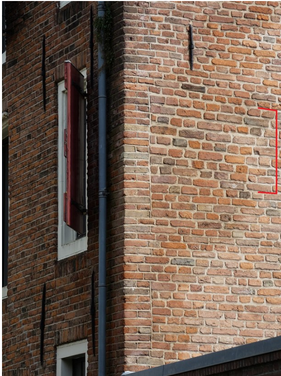
Afbeelding 3.91 De vertandingen op de hoek van de voorgevel en de zijgevel. Rechts in het midden zijn de lagen met het afwijkende grotere baksteenformaat te zien (aangegeven in rood).
