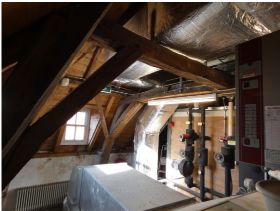
Afbeelding 3.61 Technische installaties in vertrek 2.5, in westelijke richting gezien. Rechts de bakstenen muur van het ingebouwde vertrek 2.6.
