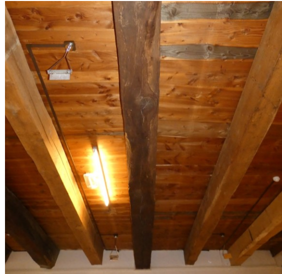
Afbeelding 3.92 Oude en nieuwe balken boven de eerste verdieping.
