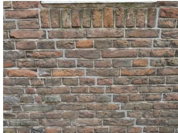
Afbeelding 3.82 Metselwerk onder het linker venster op de begane grond van de straatgevel. Hier en daar is het voegwerk later hersteld.
