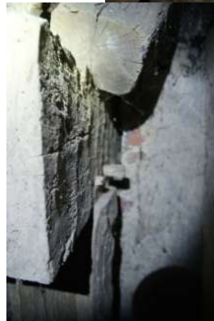
Figuur 15: Sporen van een bijl op de dekbalk van eiken van het eerste dwarsgebint van het vakwerkwoonhuis.
