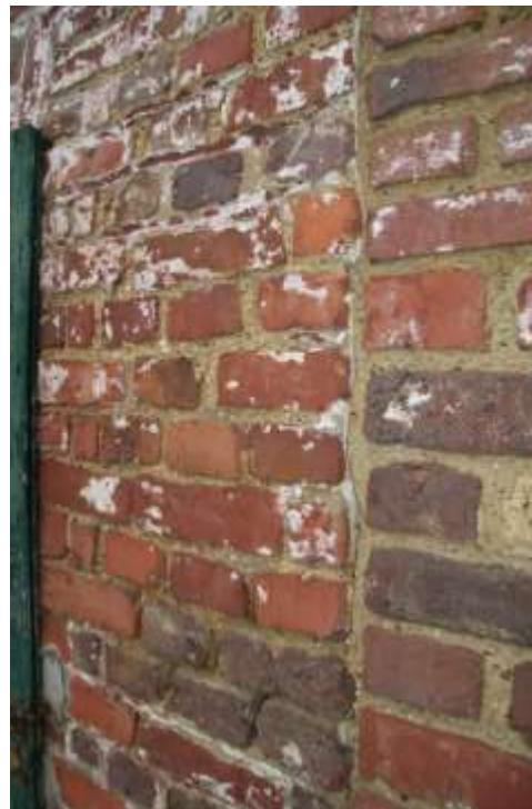
Figuur 96: met kalkspecie gemetselde veldbrandstenen in de voorgevel van bouwdeel 1b. Op de veldbrandstenen nog resten van kalkwitsel.
