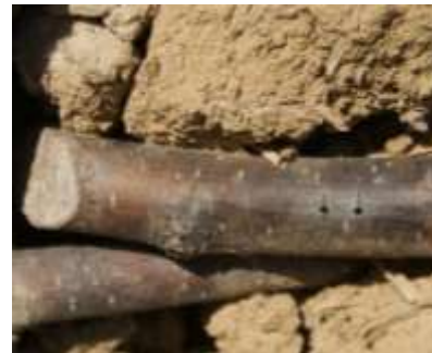
Figuur 31: Vitsen en witsen van hazelaar met daarop stroleem in de voorgevel van de aanbouw van de vakwerkwoning (bouwdeel 3d)
