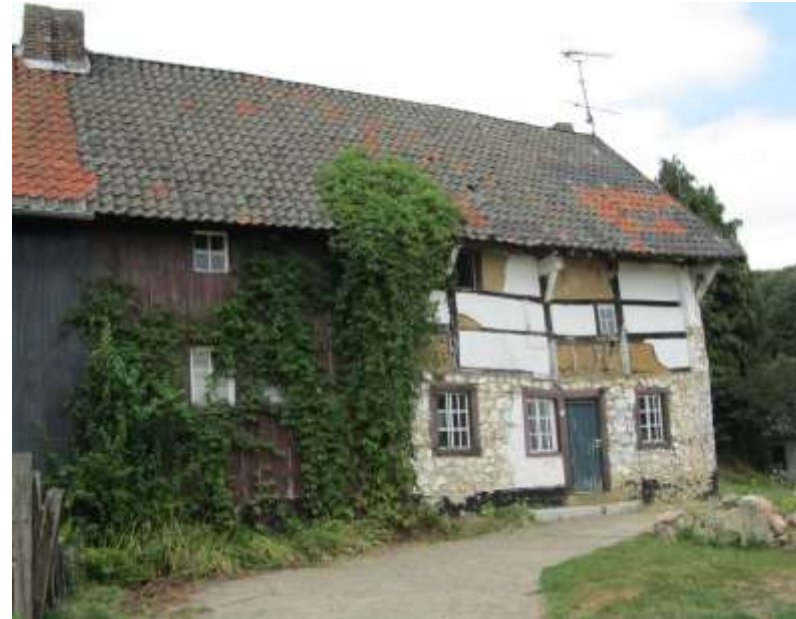
Figuur 65: Vijlense kalksteen die tevoorschijn komt achter een pleisterlaag bij de hoeve ten Bosch Cottessen 13 (XVIII) (foto: GoogleMaps, bron datering: registerblad Rijksmonumentnr: 36657)
