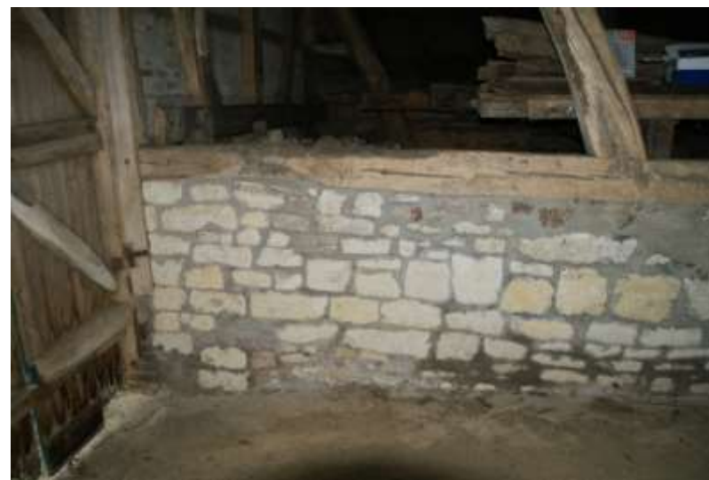
Figuur 49: Vijlense kalksteen in de muur van de wisj in de grote schuur (gebouw 1) De oorspronkelijke voeg van klakmortel is vervangen door een cementgebonden mortel.
