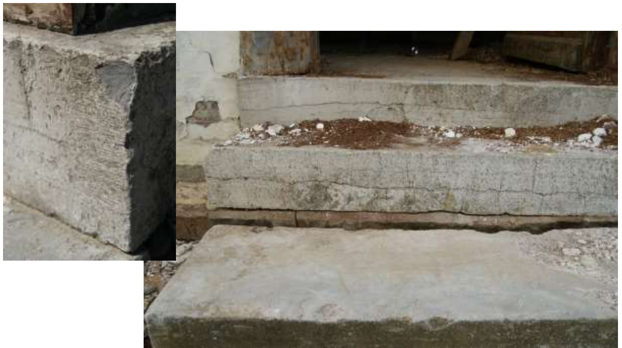
Figuur 85: Traptreden van Akense blauwsteen (Massenkalk) bij de voordeur van bouwdeel 3a. Herkenbaar aan de laterale scheuren en stromatoporen. Inzet: detail van de hoek van de trede met frijnslag.
