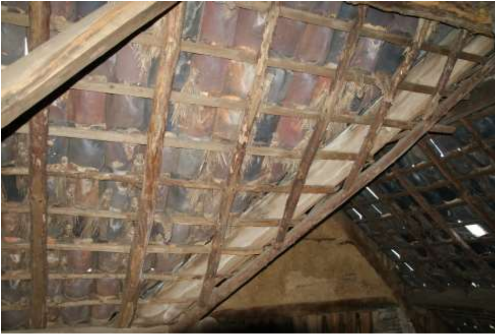
Figuur 107: Stropoppen onder de Oud-Hollandse pannen in het dakvlak van bouwdeel 3a.
