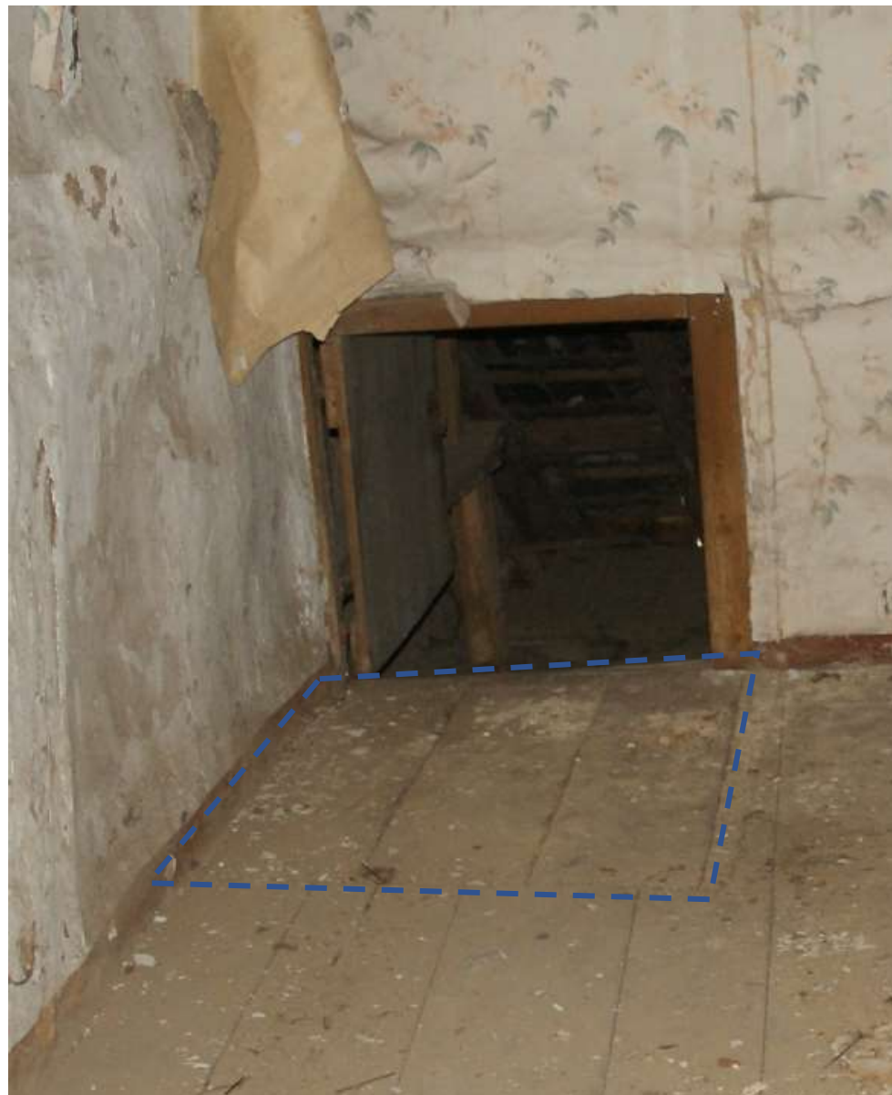
Figuur 59: De aangeheeld vloerplanken terplaatse van de luikopening in 1 e travee in de achtergevel. Hier zat mogelijk ooit een trap naar de zolder van bouwdeel 3c.
