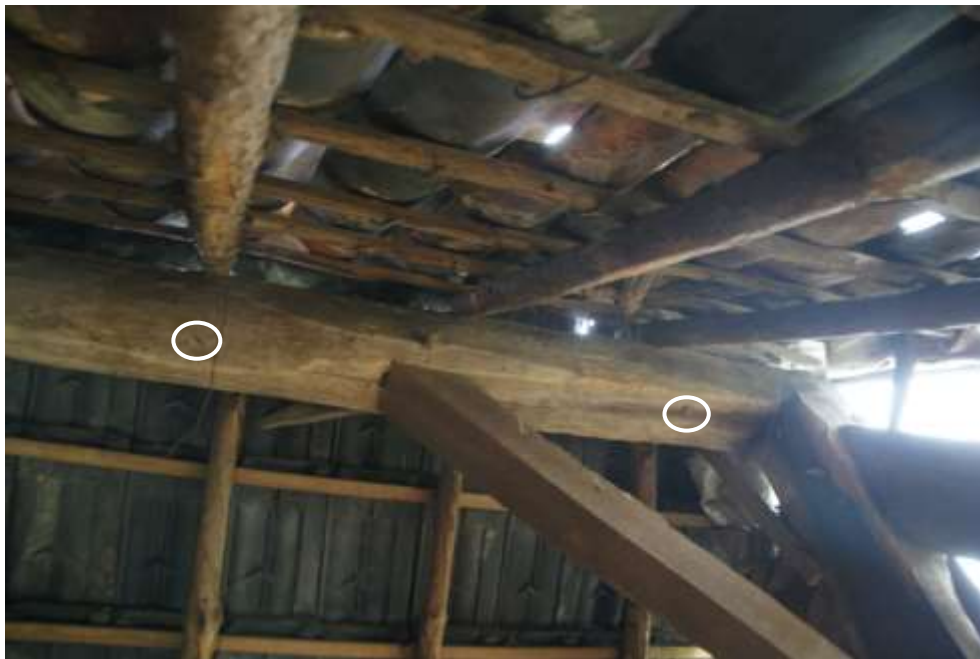
Figuur 105: De schoor van de nokbalk. Links en rechts daarnaast toognagelgaten van de bevestiging van inmiddels vervangen sporen.
