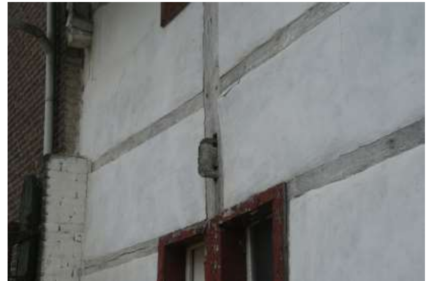
Figuur 70: De ankerpen zonder sleutels (wiggen) in de stijl van het 2 e dwarsgebint in de voorgevel
