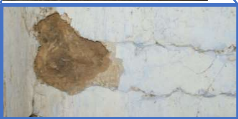
Figuur 46: De 1 e wandregel tekent zich af door scheuren in de wandafwerking.
