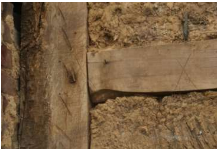
Figuur 109: Telmerk (onder de dekbalk) en paringstekens achtergevel.
