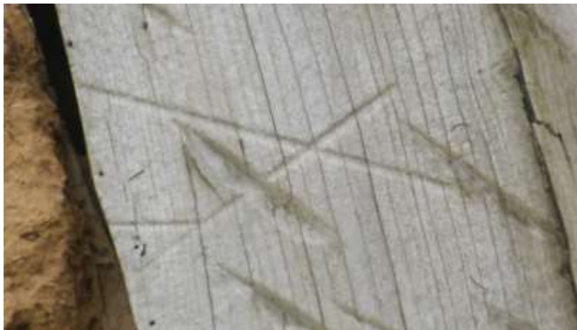
Figuur 108: Telmerk achtergevel boven de dekbalk
