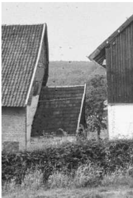
Figuur 9: Ook de gevel van bouwdeel 1d is scheefgedrukt door de schuur.
