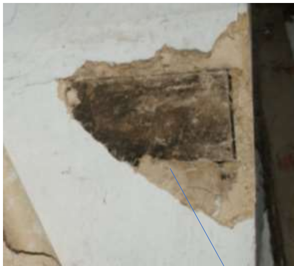
Een houten regel in het rookkanaal
