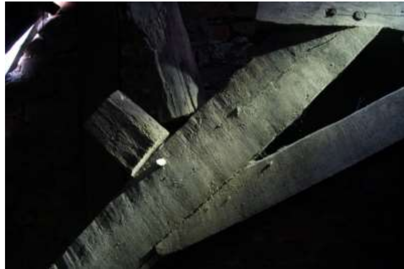
Zaagsporen van een kraanzaag op het spantbeen
