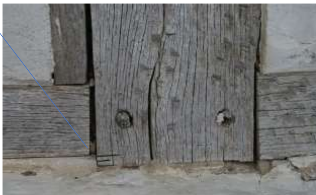
Figuur 18: Doorgezaagde stijl bij de wandregels met zaagsporen
