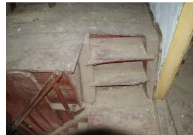
Figuur 27 (links): De trap vanaf de begane grond naar het bordes. Omcirkeld de afgezaagde kinderbint op de stijl die aan de trapboom bevestigd is.
