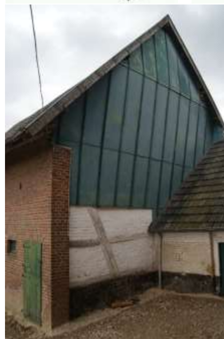
Figuur 61: De rechterzijgevel van de grote schuur (1a). De gebintstijlschoor is bij de onderste wandregels afgezaagd. De zwartgeschilderde plint van veldbrandsteen is verhoogd tot onder deze wandregels. Het bovenste deel van de gevel is bekleed met trespas. Links is de gemetselde klamp van de derde travee van de voorgevel de hoek omgezet. Rechts sluit bouwdeel 1c op de rechterzijgevel aan.
