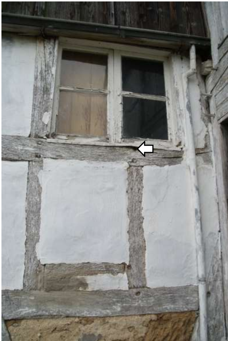
Figuur 130: Onder het venster een met stroleem gedichte luikopening. Ter plaatse van het venster zat een dubbel venster. Het toognagelgat van de middenstijl is zichtbaar (zie pijl) Rechts van de hemelwaterafvoer is de rechter stijl nog net zichtbaar.
