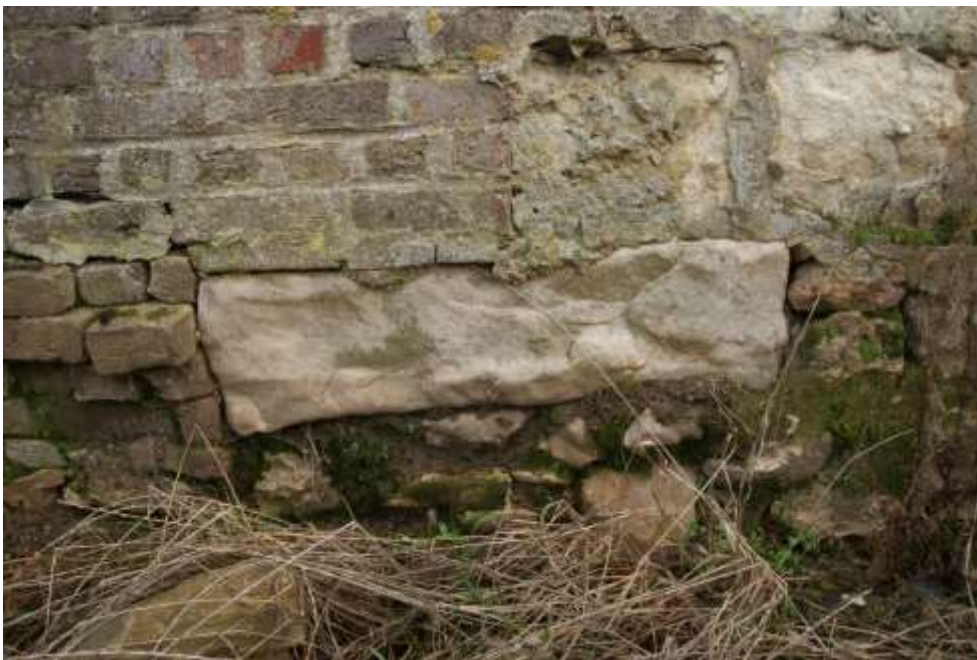
Figuur 141: Forse steen van Holset op een fundering van vuursteenkeien als aanzet voor een inmiddels door baksteen vervangen hoekketting. Daarboven, links, verweerde Vijlense kalksteen.
