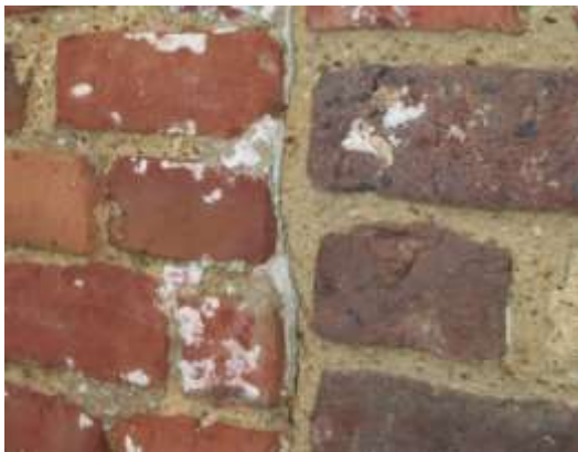
Figuur 80: Kalkwitsel op de veldbrandstenen in de bouwnaad onder de dekbalk in de voorgevel van bouwdeel 1b.
