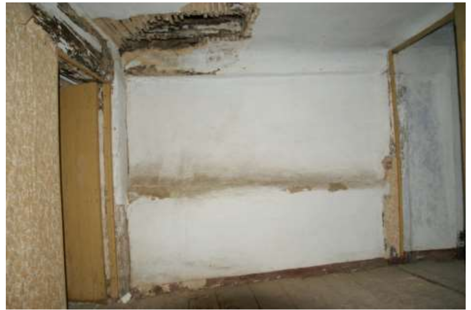
Figuur 132: Stijlen en wandregels van de achtergevel die zich aftekenen achter het pleisterwerk op de 1e verdieping van bouwdeel 3a.
