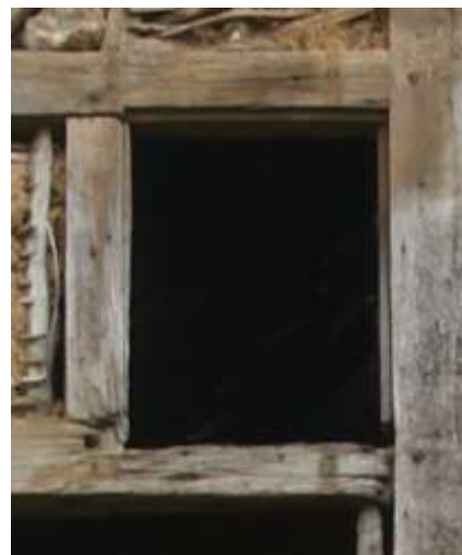
Figuur 143: Op zolderniveau een oorspronkelijke luikopening ter herkennen aan de sponningen op de boven- en onderregel en de linker stijl en het gebruik van een pen-en-gat verbinding met toognagels. Deze zouden bij een later ingebrachte luikopening ontbreken.
