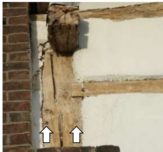
Figuur 10: De stijl van het overgebleven dwarsgebint van de oude woning in de voorgevel. Daarop sluit onder de debalk een regel aan van bouwdeel 3a die bevestigd is met een smeedijzeren nagel. Daaronder links en rechts twee toognagelgaten waarop de oorspronkelijke wandregels van het oude woonhuis aansloten (pijl)
