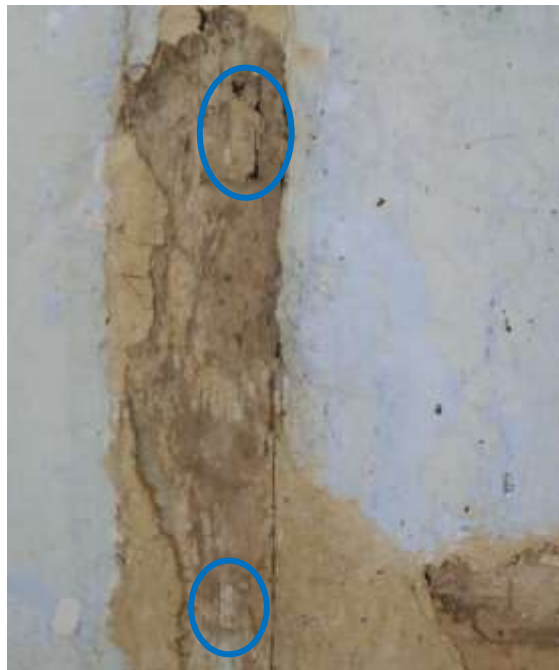
Figuur 22 (rechts): afgezaagde pennen van de regels van de wand tussen de gang en de keuken in de stijl van de rechterzijgevel
