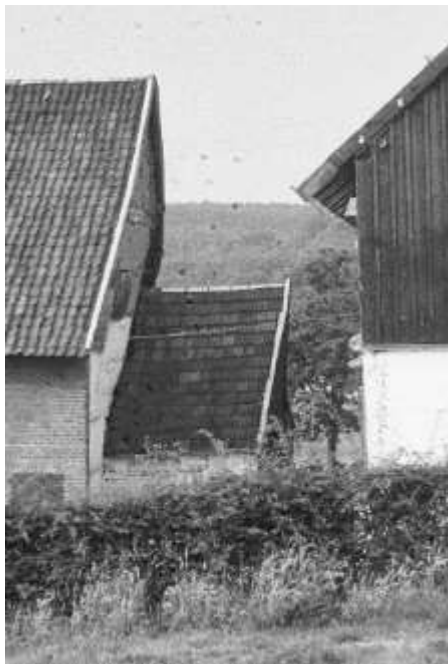
Figuur 43: Ook de gevel van bouwdeel 1d is scheefgedrukt door de schuur.
