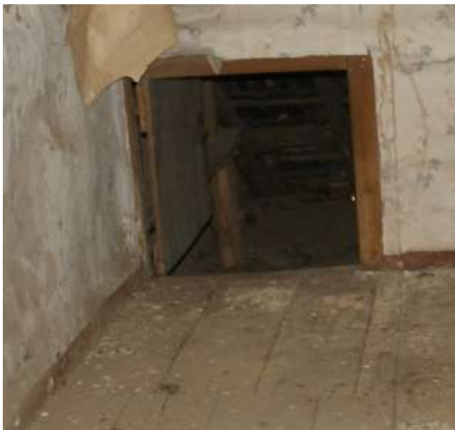
Figuur 25: De drie aangeheeld vloerdelen in de 1 e verdiepingvloer in de eerste travee. Waarschijnlijk vervangen vanwege regendoorslag bij het luik of gebruiksslijtage.
