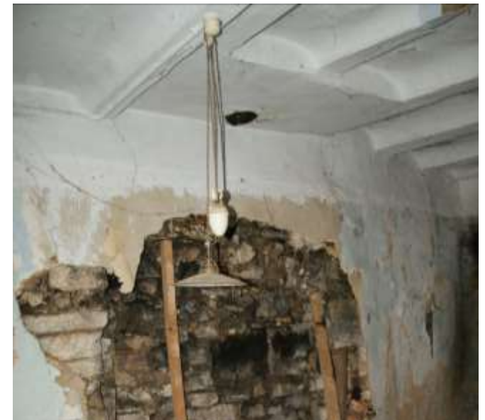
Figuur 23: De beroete achterwand van de haard met daarboven de raveling voor het rookkanaal. Daarin is ook nog de doorvoer voor de kachelpijp zichtbaar.
