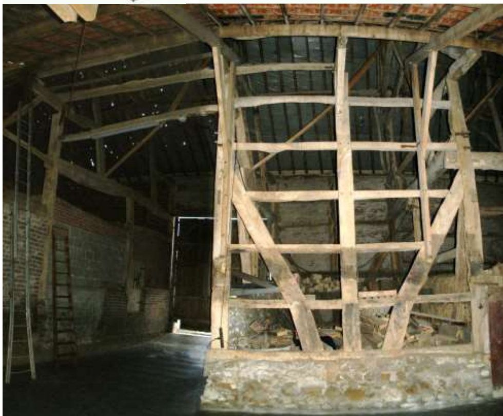
Figuur 59: Eerste en tweede travee van de achtergevel van de grote schuur (1a). De eerste travee op een plint van vuursteen keien in oktober 2020. In de tweede travee ontbreken een aantal wandregels, de stijlvoetplaat en de plint.
