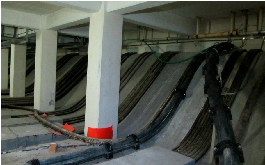
Afb. 2 De kabelgoot in de kabelkelder. (foto Willard van Reenen)
