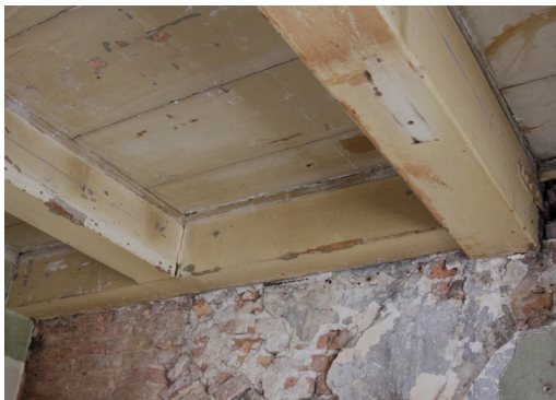
Afb. 2 De als strijkbalk uitgevoerde raveling in de zolderbalklaag van Molenstraat 19. (foto auteur, mei 2017)
