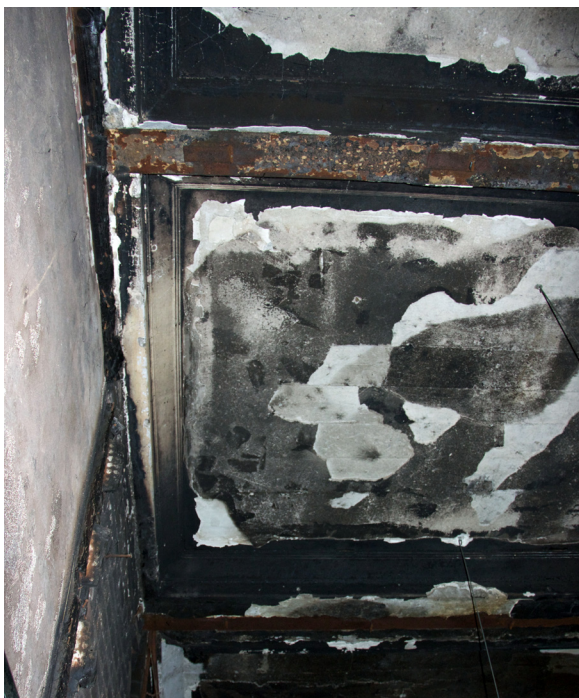
Afb. 13 Aan de achterzijde, waar de hitte van de brand het grootst was, zijn de afdrukken van de bekisting in het zicht gekomen. (foto P.J. Bosman, december 2015)
