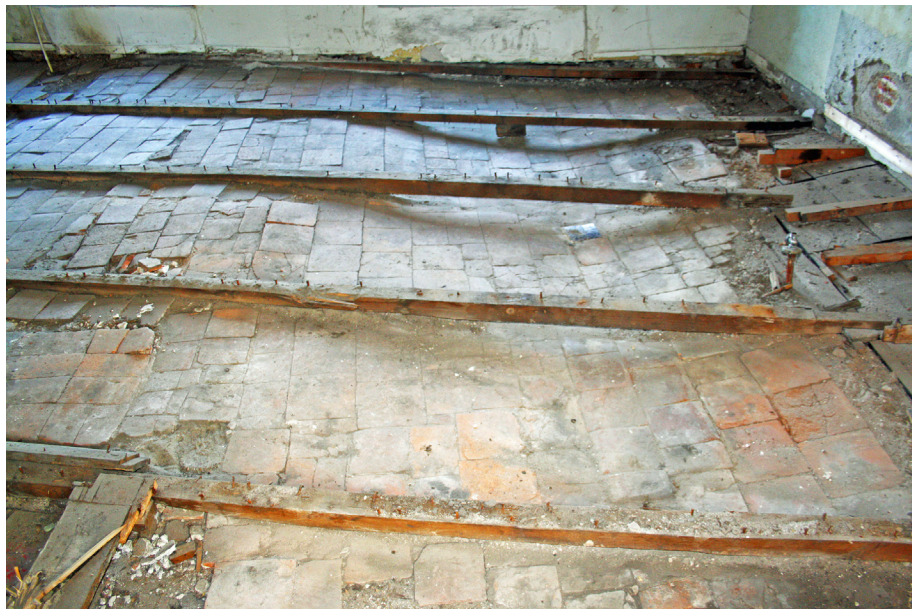
Afb. 6 Detail van de doorgezakte plavuizenvloer. (foto Vakteam Erfgoed gemeente Dordrecht)
