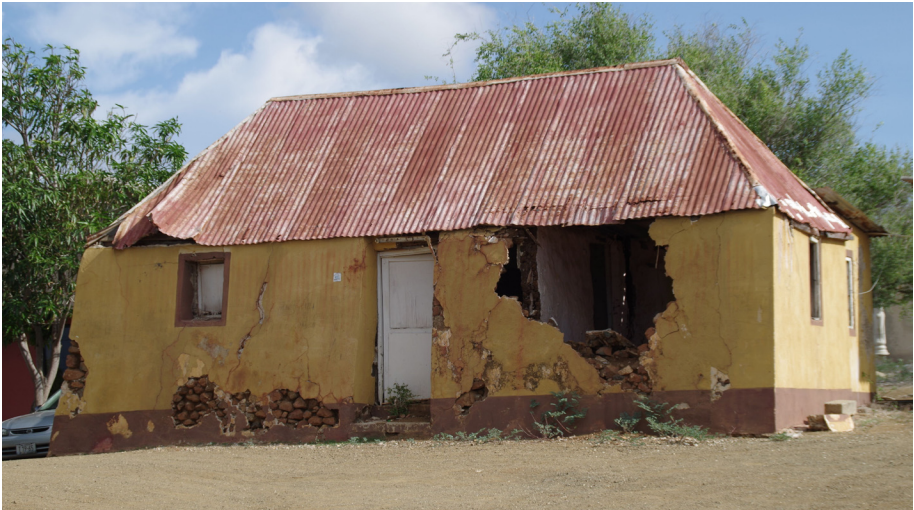
Afb. 7: Kunukuhuis op het noordelijke deel van Curaçao met, door zijn verwaarloosde staat, goed zicht op de muren van koraalsteen in leem. (foto auteur 2014)
