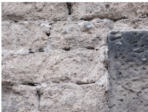
Afb. 7: De aansluiting van trachiet op de verhakte ( en ook verweerde) tufsteenlagen komt niet precies overeen met de lagenmaat. Zie afb. 5, gemarkeerd punt A. (foto auteur)
