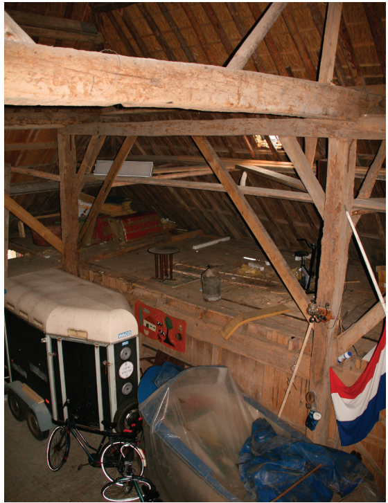
Afb. 1 Het westelijke gedeelte van het vierkant uit ca 1559. Links de zuidwestelijke gebintstijl en rechts de noordwestelijke gebintstijl van dit vierkant. Boven laatstgenoemde stijl is de liplas zichtbaar die de zestiende-eeuwse met de zeventiende-eeuwse westelijke dekbalk verbindt. (foto F. Grovestins)
