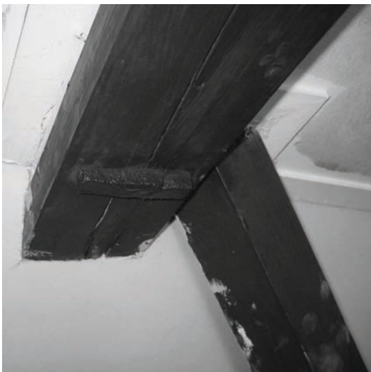
Afb. 9 - De hangconstructie met T-vormige spiebout in Haarlemmerstraat 170 uit de 17 de eeuw. (foto E.D. Orsel)
