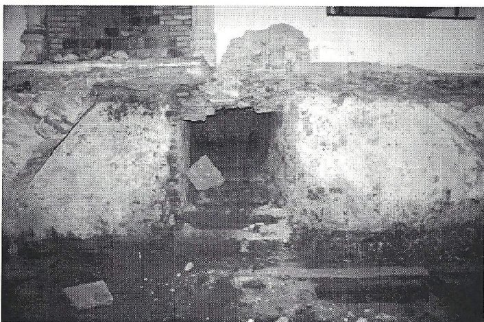
De westmuur van de kelder met de teruggevonden muurtrap. Deze leidde oorspronkelijk naar een buitentoe-gang. (foto K. Emmens)
