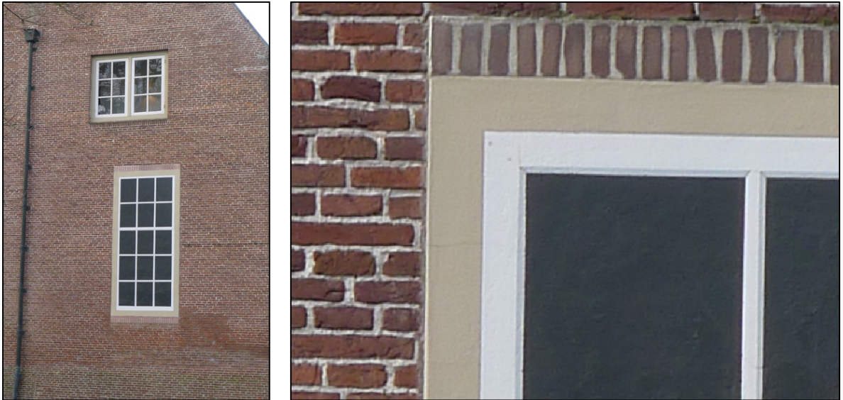
Af. 11 en afb. 12: Groenevelds imitatievenster, steeds dichterbij. Zelfs de hoekverbinding met deuvels, houtkieren en de schaduwwerking zijn geschilderd [foto's R. Stenvert]
