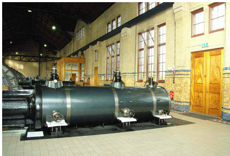
Afb. 1: Interieur van de machinehal van het Ir. D.F. Woudagemaal te Lemmer uit 1916-1920
