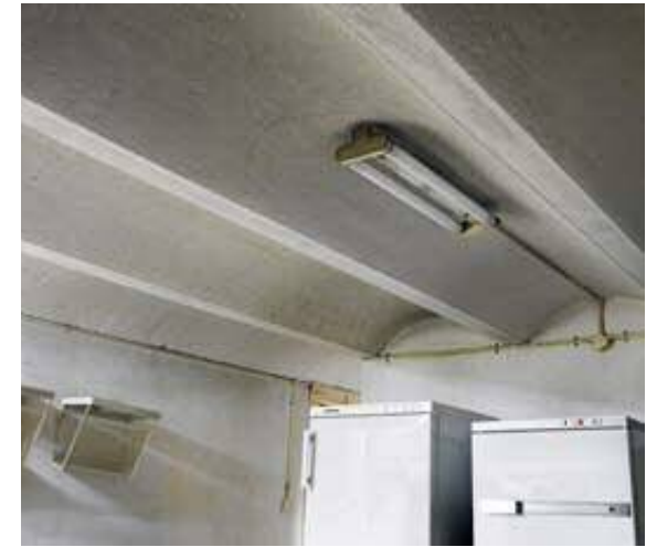
AFB. 3 JOHAN VERHULSTSTRAAT 111, TROGGEWELFJES IN DE KELDER
