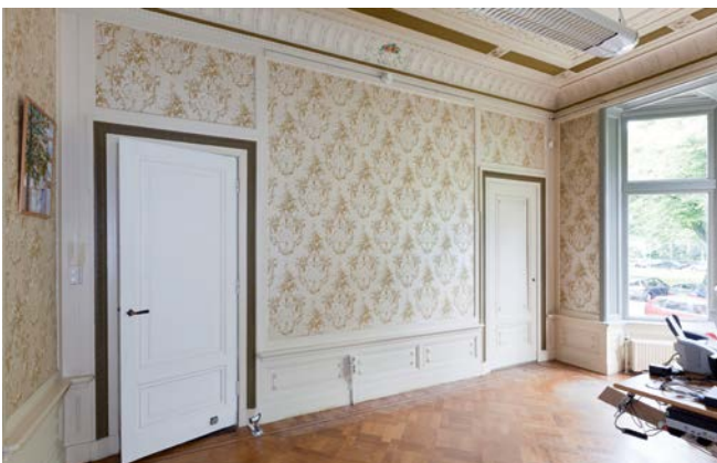
8. Wandgeleding van één van de wanden in een kamer van het in 1910 gebouwde herenhuis Parklaan 14 te Rotterdam
