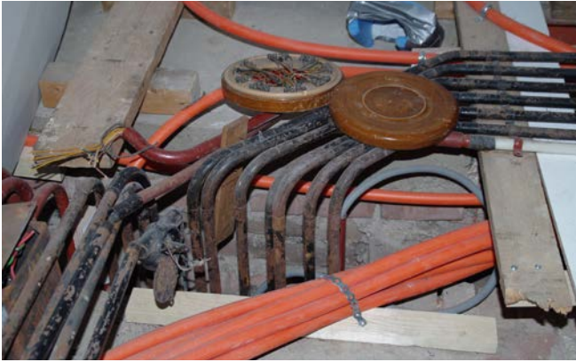
12. Detail van de installatie van Jachtslot St.-Hubertus met in het midden de opengemaakte houten verdeelkast van de zwakstroominstallatie voor het bellenbord (foto rs)
