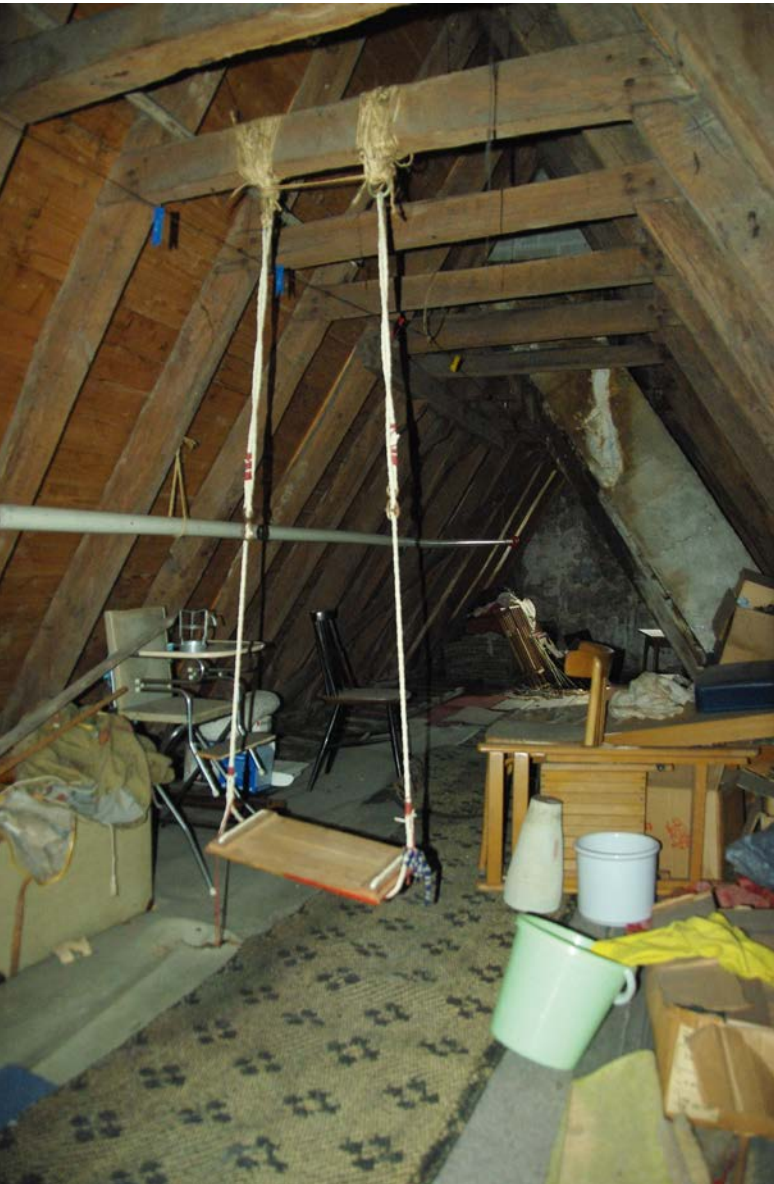
2. Zolder van een pand aan de Melkmarkt in Zwolle uit circa 1660 met een ongewone inkijk in de private sfeer van een woonhuis (foto rs)
